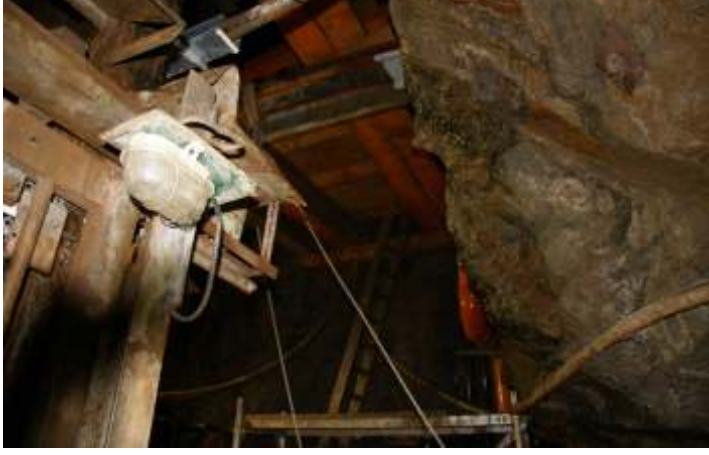
Die Beschaffenheit der Grube neben dem Förderkorb, von dem es über Fahrten (Leitern) bis auf eine Tiefe von 460 Metern nach unten geht
