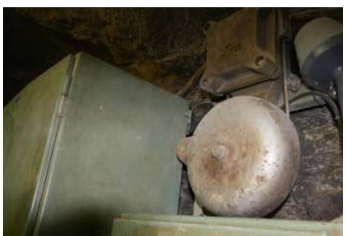
Die Glocke mit der gut hörbar die Signale unter Tage für das Auf- und Ab des Förderkorbes und den Zweck der Fahrt gegeben werden
