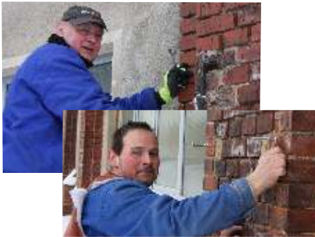
Mit einer vorgefertigten Schablone sicherten die ZSB-Kollegen die präzise Montage der 100 Kilogramm schweren Gedenktafel
